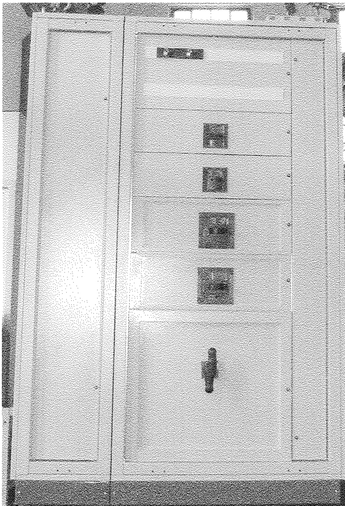
F.1 Vista generale del quadro
