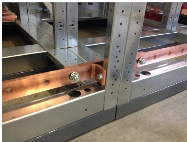
Particolare della sbarra di terra, con collegamento alla struttura e piastra di giunzione tra le unità di trasporto.
